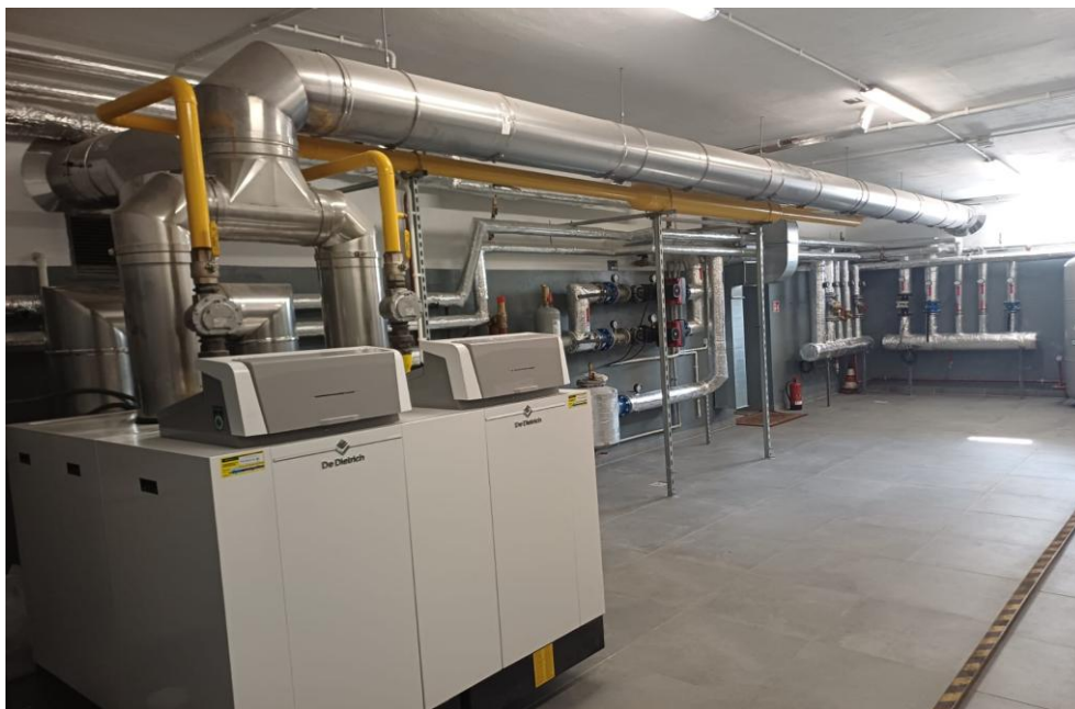
Kotłownia gazowa przy ul. Armii Krajowej 13 w Pińczowie
