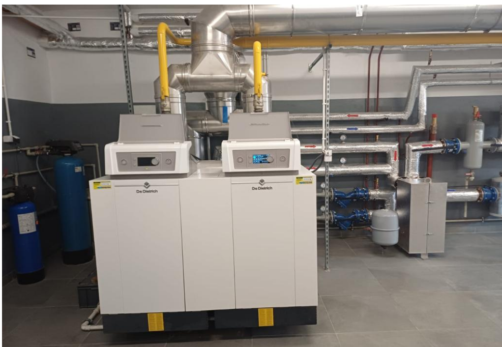
Kotłownia gazowa przy ul. Armii Krajowej 13 w Pińczowie
